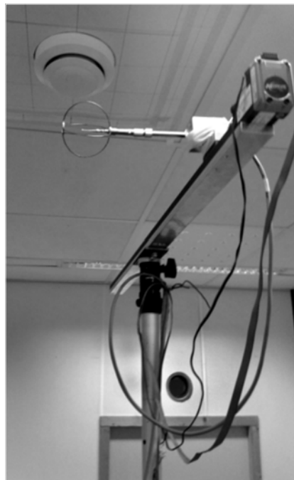
-Figuur 1- Meetopstelling voor het meten van het snelheidsprofiel van een van de onderzochte toevoerventielen (axiaal)
