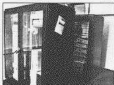
Obr. 10 Řídicí počítač budovy neslouží v tomto případě pouze pro tuto budovu, ale používá se i pro monitorování vzdálených objektů
