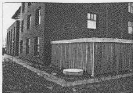
Obr. 5 Studna podzemní vody pro tepelné čerpadlo a chlazení budovy
