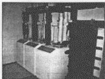
Obr. 6 Tepelná čerpadla pro vytápění budovy
